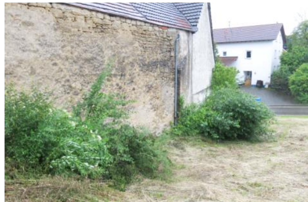
Entlang der Mauer zur angrenzenden Scheune stockt Gehölzjungwuchs.
