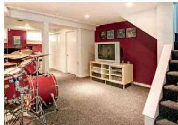
Hobbyräume im Keller – riskant bei Hochwassergefahr
